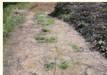
• 사곡지 저수지 둑 균열
