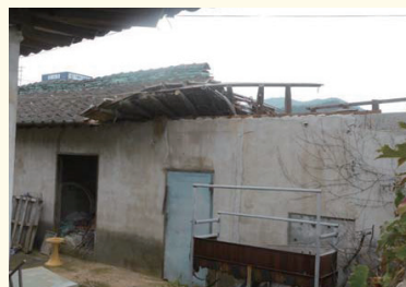
• 창고 지붕 파손
