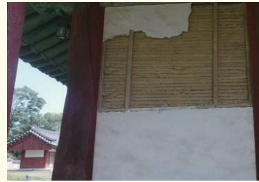
• 경주 향교 벽체 파손
