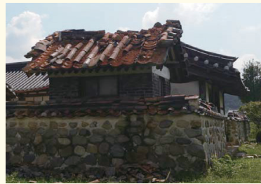
• 사마소 지붕 기와 파손
