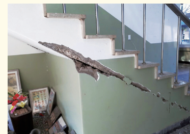
• 포항흥해공고 계단 균열
