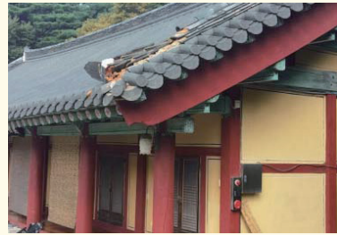
• 불국사 지붕 기와 파손
