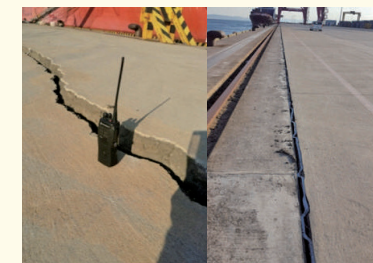
• 영일만항 부두 포장용기 및 균열
