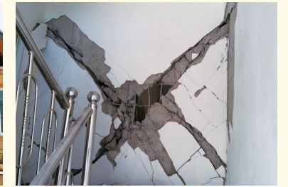
• 장량동 기예공 주택 내벽 파손
