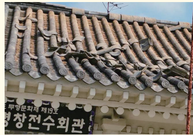
• 무형문화재 전수관 지붕 기와 파손
