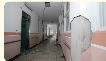
건물 내부 벽체 파손
