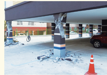
• 장량동 크리스탈 필로티 기둥 파손
