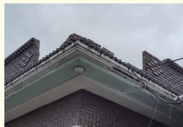
• 주택 지붕 난간 파손
