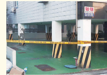
• 장량동 오서빌 필로티 파손
