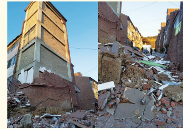
• 환여동 대동빌라 외벽 치장벽돌 탈락
