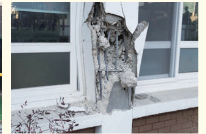
• 흥해초등학교 건물 기둥 파손
