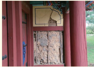
• 신문왕릉 건물 벽체 파손
