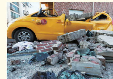
• 조적도 외벽 파손으로 인한 차량파손
